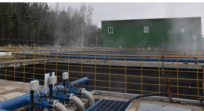
ООО «УНТЕКС РОДНИКИ» Резервуар-усреднитель Дата разрешения на ввод объекта в эксплуатацию: 08.12.2025 г.
